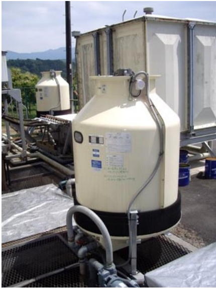
20RT クーリングタワー タワー下は 2.2 m 3 ×2 槽 合計 4.4 m 3 の冷却水槽有り
